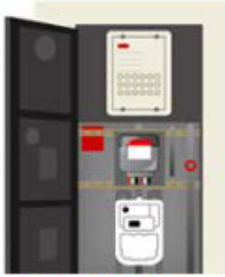
共用廊下等のメーターボックス内に設置の例
