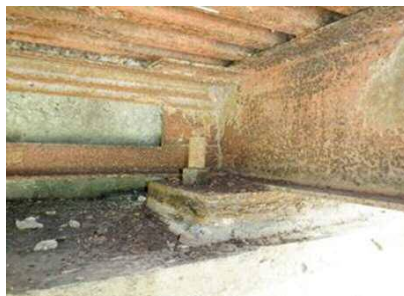
図-1.3 鋼橋の損傷状況
