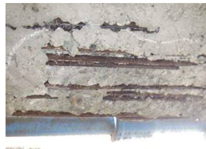
図-1.4 コンクリート橋の損傷状況
