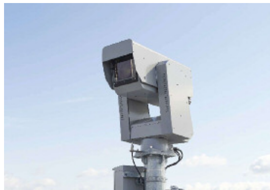
高所監視カメラ
