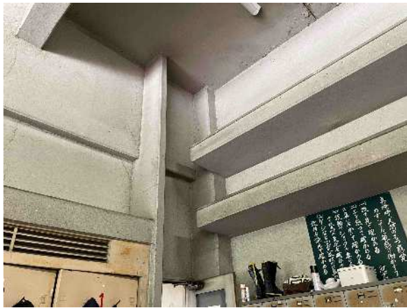
車庫(屋根スラブ露筋・壁クラック)
