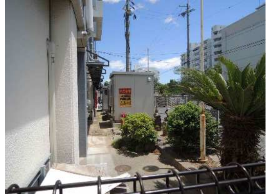
非常電源設備(72 時間対応)
