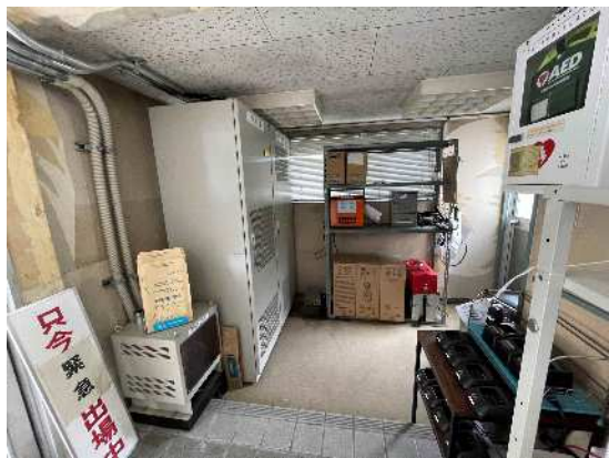
通信機器収納スペース
