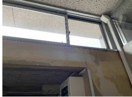
通信機器収納スペース上部
