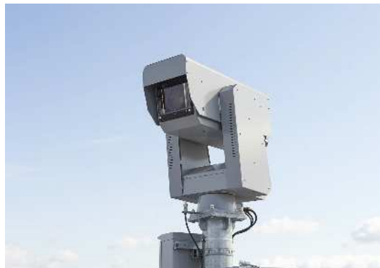
高所監視カメラ
