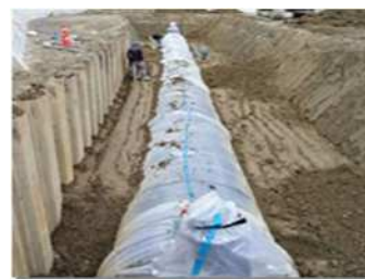
五月山緑地防災備蓄倉庫敷地の地中にある耐震性貯水槽
