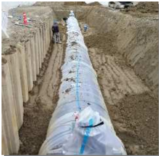
五月山緑地防災備蓄倉庫敷地の 地中にある耐震性貯水槽
