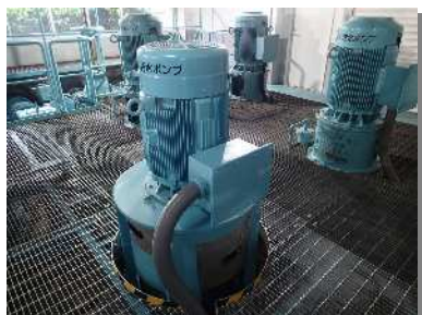
高効率の機器の導入 (更新工事 5,080 万円)
