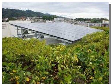
上下水道庁舎の 太陽光発電システム
