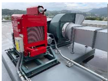
古江浄水場排煙設備
