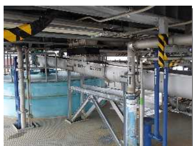
下水処理場汚泥搬送設備
