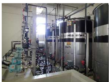
下水処理場 次亜塩素酸ソーダ貯留槽
