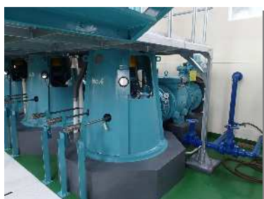
下水処理場放流ポンプ
