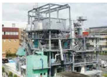
最先端技術を採用!「下水処理場」の汚泥処理施設
