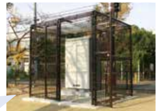
自動水質監視設備
