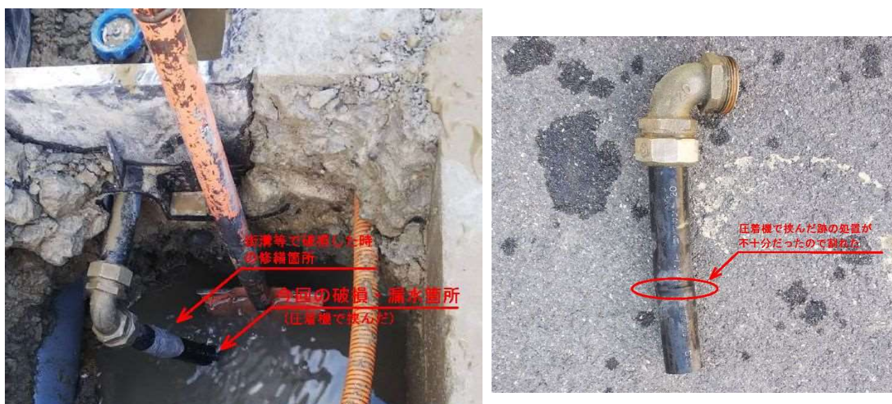
図6-2 圧着部分の破損
