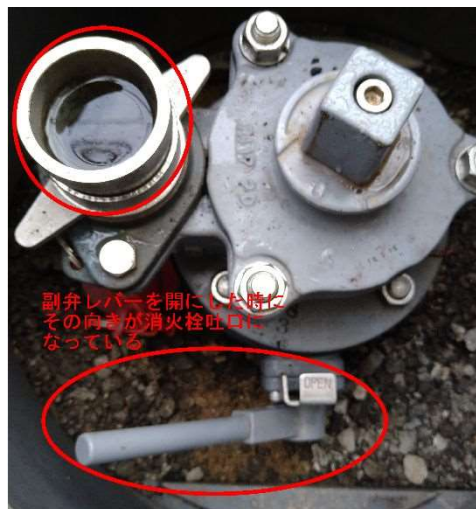
図4-53 消火栓の補修弁レバーの向き
