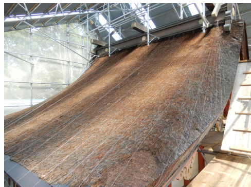
全面的に劣化した檜皮葺屋根
