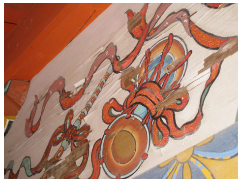
剥離・剥落した塗膜
