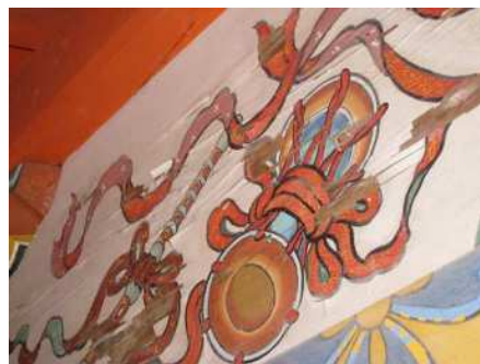
③剥離が生じた胡粉塗
