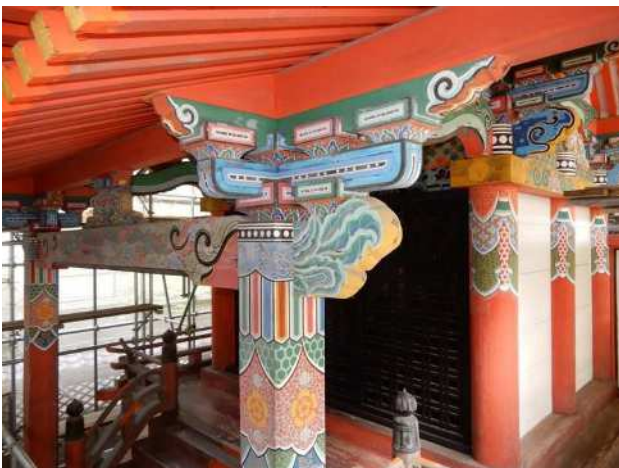
①褪色、塗膜の剥落が顕著な塗装
