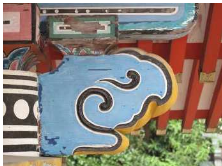
②上塗が剥落し下塗が露出
