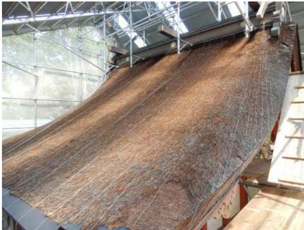
①破損した檜皮葺屋根
