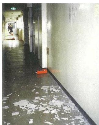
廊下の壁の崩れ
