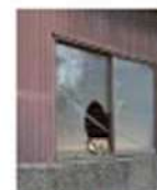
窓が割れた 管理不全空家
