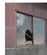
窓が割れた管理不全空家
