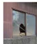
窓が割れた管理不全空家
