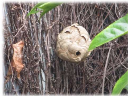
ハチの巣の状況(令和3年9月)
