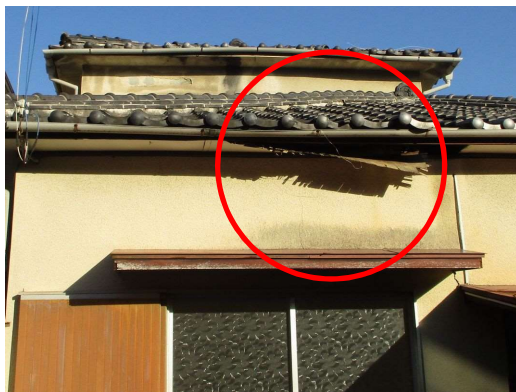
屋根の劣化の状況
