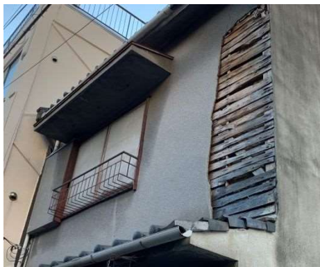
外壁剥落の状況
