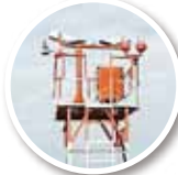
かつそうろ しきよりかんそくそうち 滑走路視距離観測装置RVR
