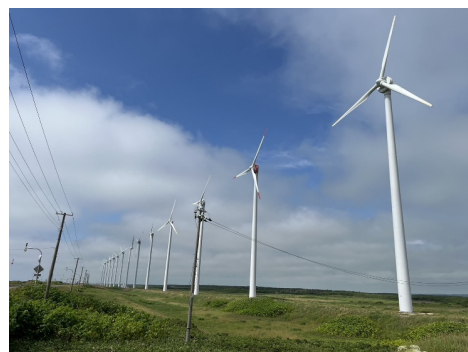
図 3-10 風力発電所参考例
