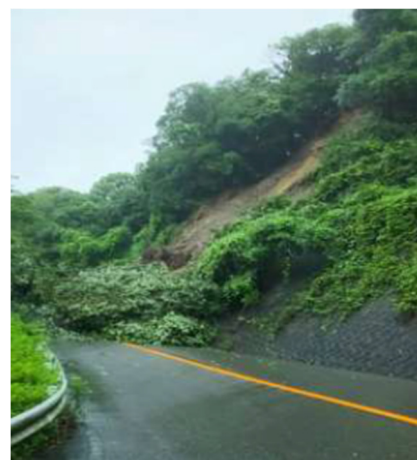
図 2-3 豪雨による被害の様子 (平成 30 年 7 月 5 日～8 日)
