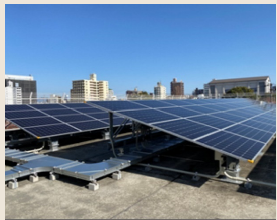
図 4-6 久留米市環境部庁舎の太陽光発電設備 （出典：環境省 ZEB PORTAL）
