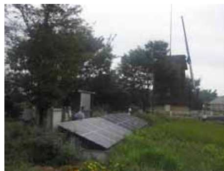
公園内に設置された太陽光発電
