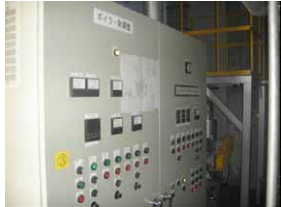
ボイラ制御盤
