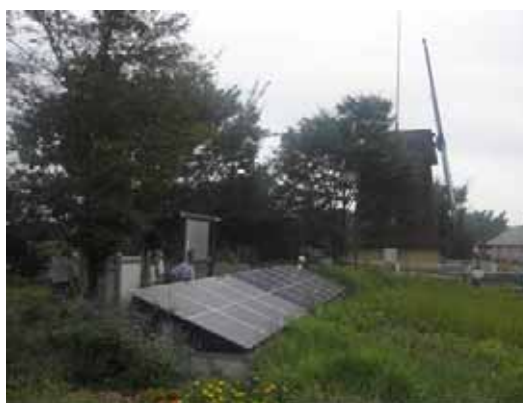
太陽光発電所【滋賀県高島市】
